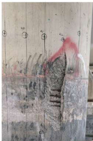
写真: 橋脚5 剥離したコンクリート
